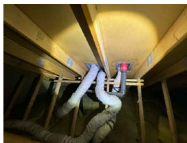
Fuktmerker rundt luftehatter
