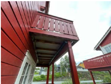
Oversiktsbilde av påviste avvik ved søyle.
