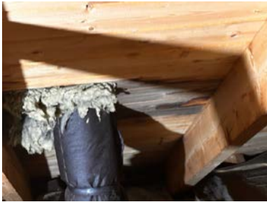
Fuktskjolder rundt takgjennomføring hvor det ble funnet fuktighet.
