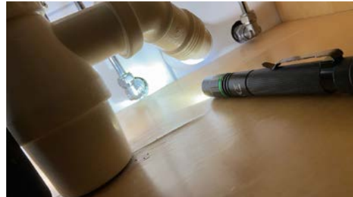
Manglende tetting rundt rør i våtsone under vask
