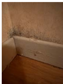
Muggsopp/svertesopp i hjørnet på ett av soverommene
