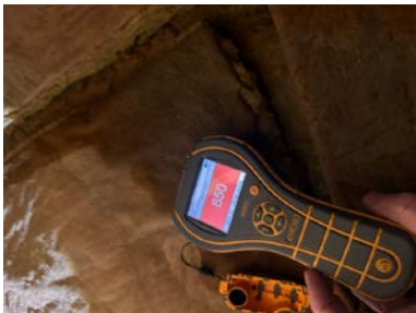
Indikasjoner på fuktighet på isolasjon med fuktsøk
