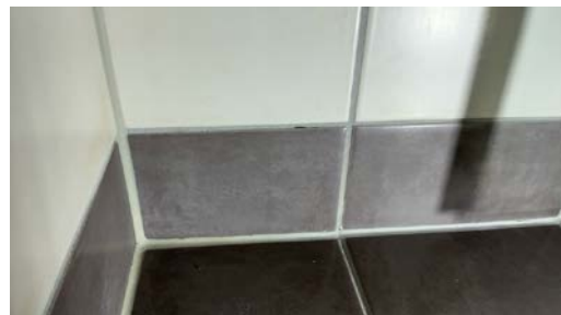
Liten riss/ manglende rugemasse i dusjen
