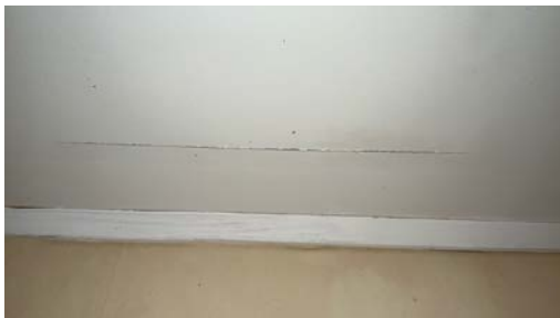
Sprekk i takoverflate
