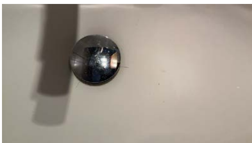
Små riss rundt sluk i vask
