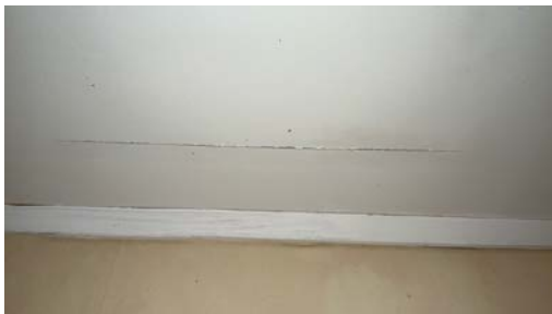
Sprekk i takoverflate
