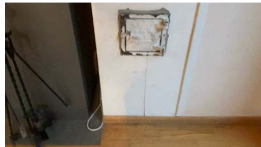
Rennemerke, samt manglende plate på gulvet
