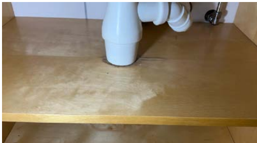
Svelling i baderomsinnredning
