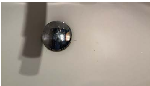
Små riss rundt sluk i vask
