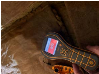
Indikasjoner på fuktighet på isolasjon med fuktsøk
