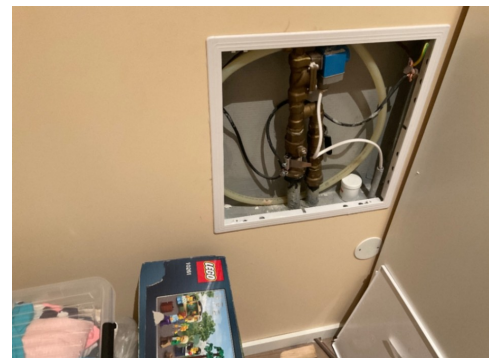
Hovedstoppekran med vannstopp og sensor på kjøkkenet
