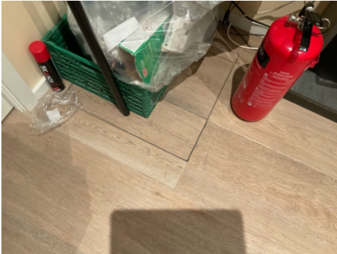
Plassering av luft aggregat i gulv, bolig
