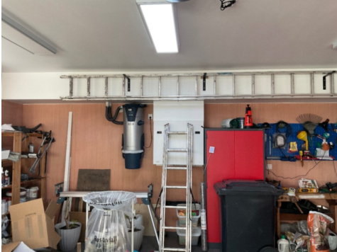
Ventilasjonsaggregat til boligen i garasjen
