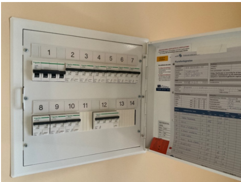
Sikringsskap i leiligheten
