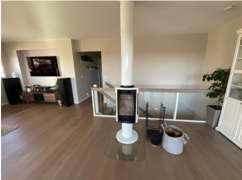
Contura vedovn i stuen med isolert stålpipe
