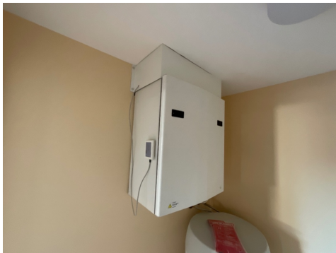
Ventilasjonsaggregat til leiligheten i boden
