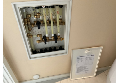
Rør i rør skap i leilighet i 1. etasje
