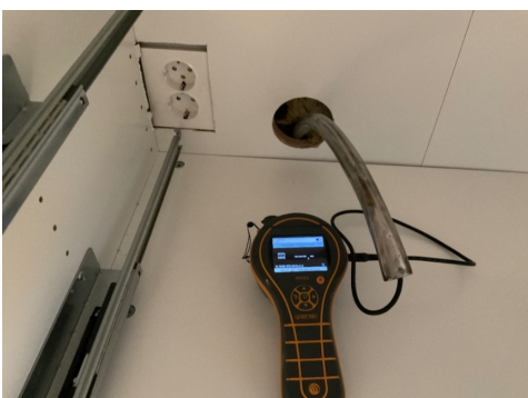
Hulltaking i garderobe, bad 2. etasje
