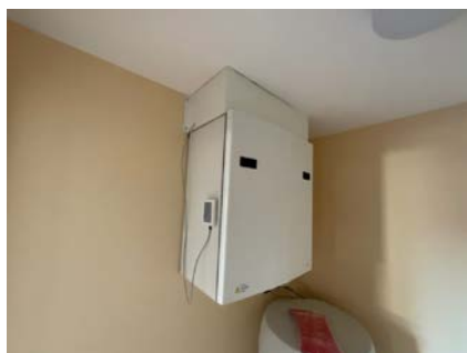
Ventilasjonsaggregat til leiligheten i boden
