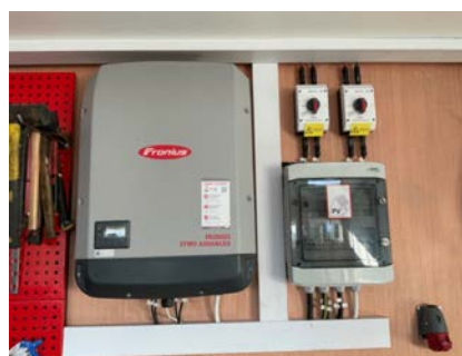
Styring solceller i garasjen
