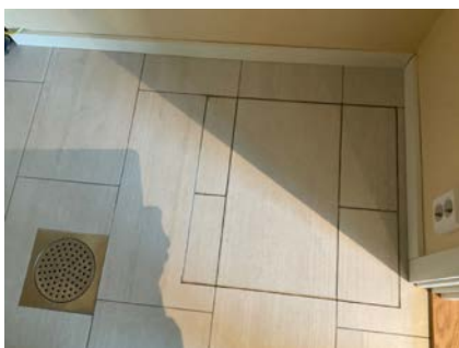
Plassering av luft aggregat i gulv, leilighet
