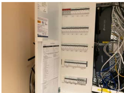
Sikringsskap til boligen
