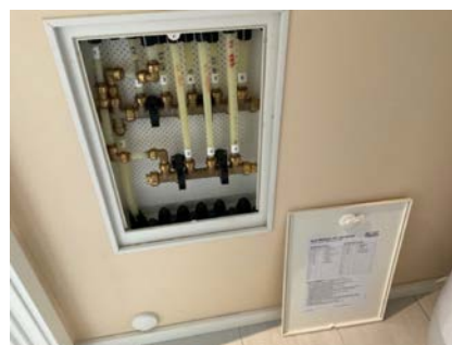
Rør i rør skap i leilighet i 1. etasje
