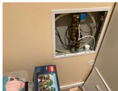
Hovedstoppekran med vannstopp og sensor på kjøkkenet
