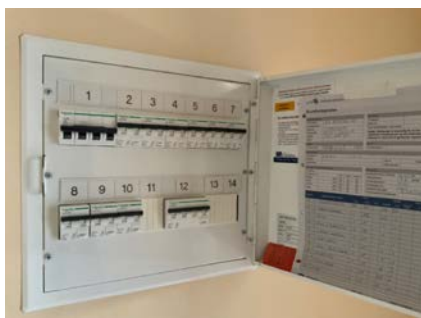
Sikringsskap i leiligheten
