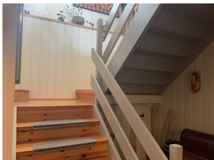
Håndløper mangler på vegg.
