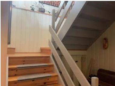
Håndløper mangler på vegg.
