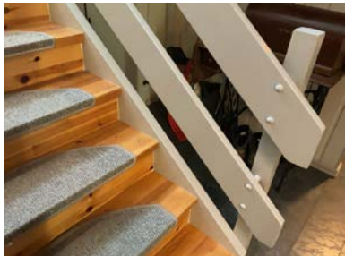
Åpninger i rekkverk over.10 cm. Målt 16 cm.
