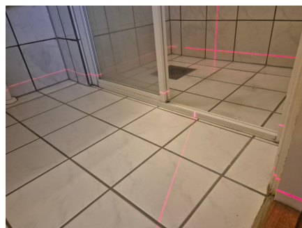
Flere løse fliser på gulvet.
