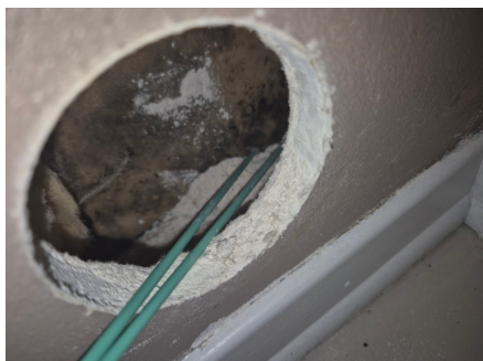
Fuktskadene har gjort at gips platene er porøse.
