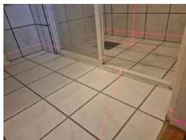
Flere løse fliser på gulvet.
