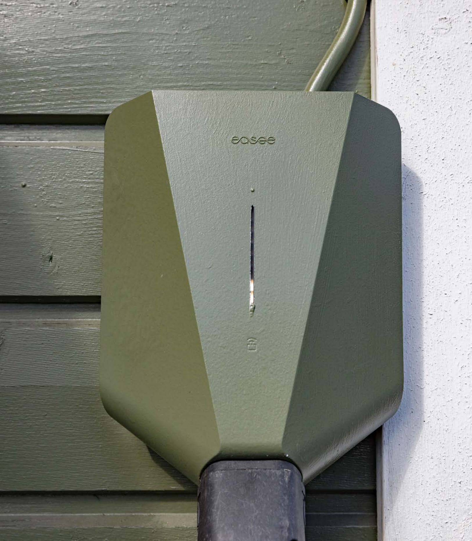
Det er montert Easee elbil-lader på husveggen.
