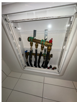
Samleskap med rørkurser og stoppekraner
