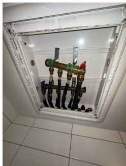
Samleskap med rørkurser og stoppekraner
