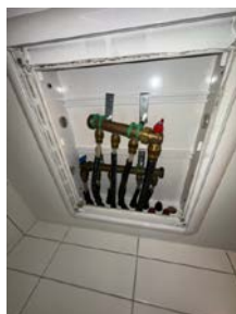
Samleskap med rørkurser og stoppekraner
