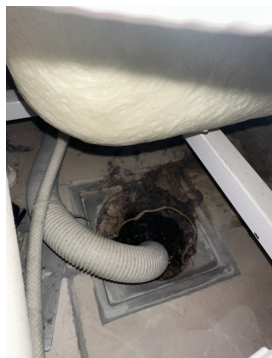
Sluk i plast, plassert under badekar
