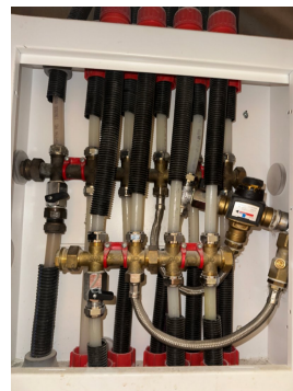
Samleskap plassert på vaskerom
