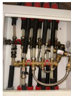
Samleskap plassert på vaskerom
