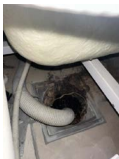
Sluk i plast, plassert under badekar
