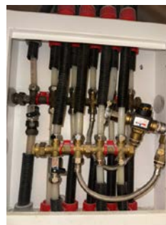
Samleskap plassert på vaskerom
