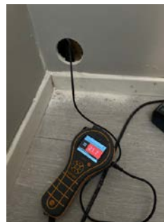
Fuktmåling i soverom i U.etg. nord/vest side
