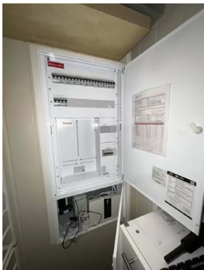
Viser innfelt sikringsskap med ekom del.
