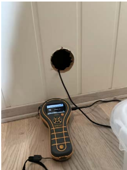
Viser fuktmåling fra tidligere hull på soverom.
