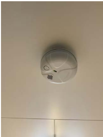
Viser brannmelder i gang.
