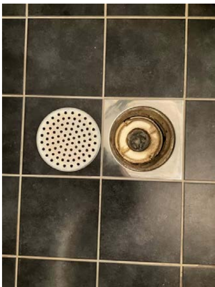
Viser sluk i dusjsone.
