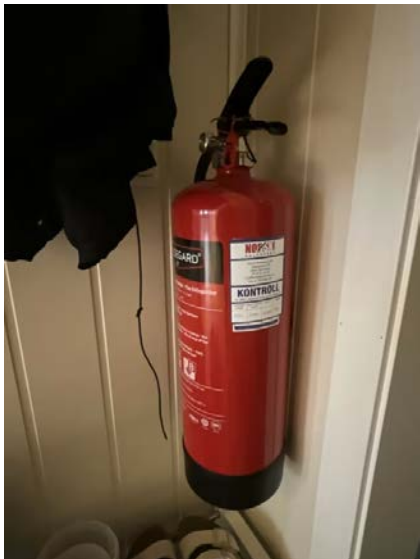
Viser brannslukningsapparat ved inngang.
