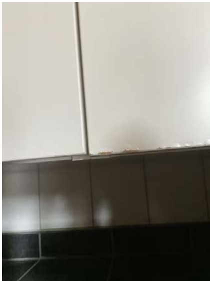
Viser små fuktskader på baderomsinnredning.
