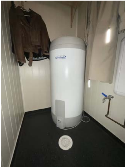
Viser bereder plassert i bod.
