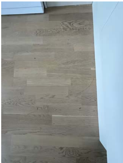
Overflate gulv med noen merker.
