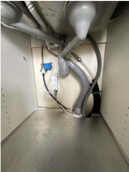
Viser vann- og avløpsinnstallasjoner under kum.
