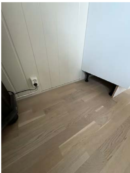
Viser manglende gulvlist og sokkel.
