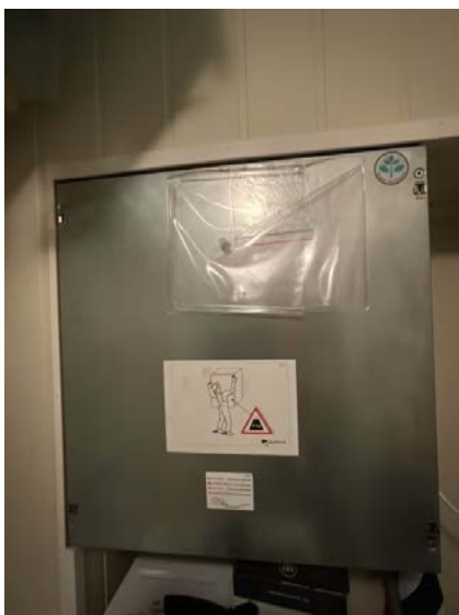
Viser ventilasjonsaggregat plassert i bod.
