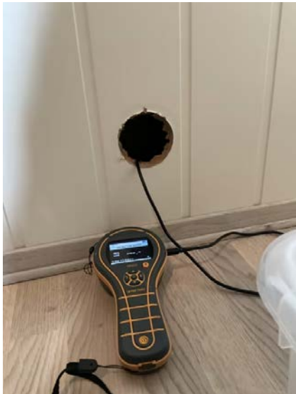
Viser fuktmåling fra tidligere hull på soverom.
