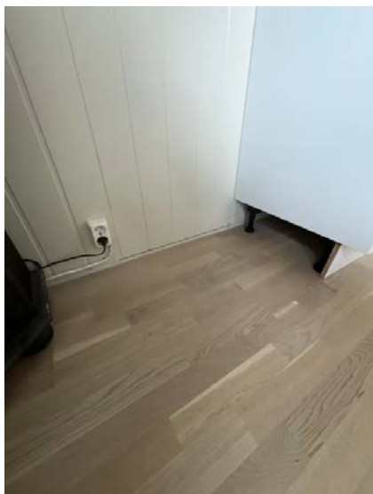
Viser manglende gulvlist og sokkel.
