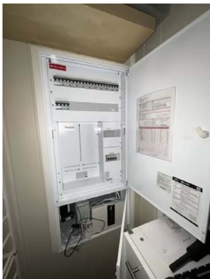
Viser innfelt sikringsskap med ekom del.
