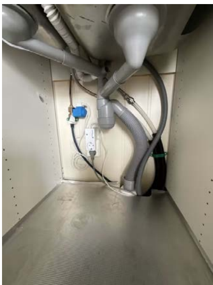
Viser vann- og avløpsinnstallasjoner under kum.
