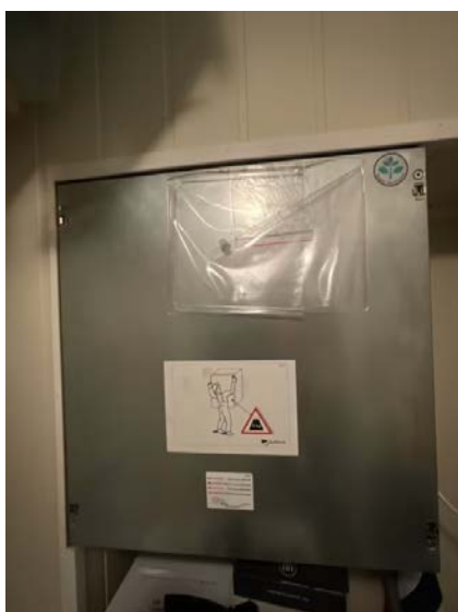
Viser ventilasjonsaggregat plassert i bod.
