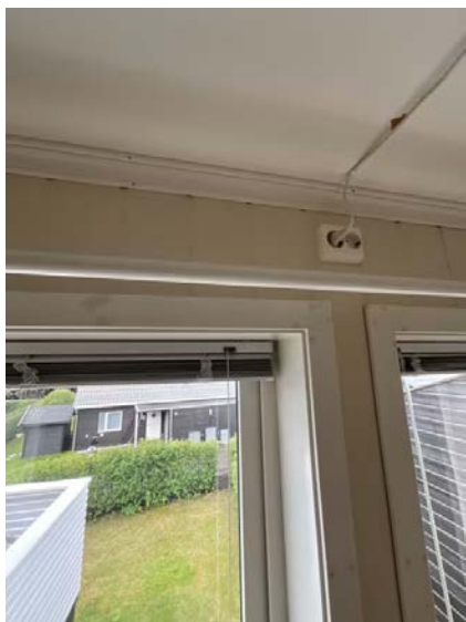
Påbegynt sparkling av spikerhull er ikke ferdigstilt.
