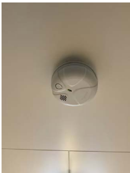
Viser brannmelder i gang.
