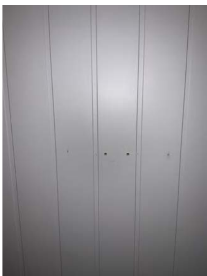
Merker på vegg etter eldre oppheng.
