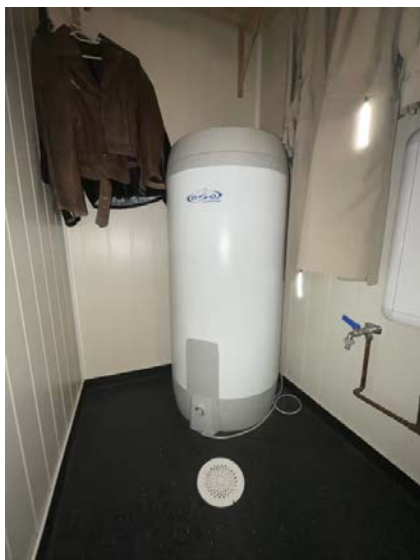
Viser bereder plassert i bod.
