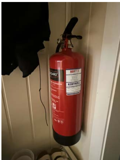
Viser brannslukningsapparat ved inngang.
