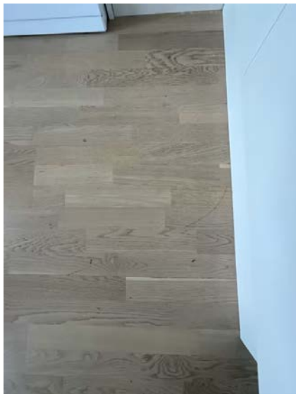
Overflate gulv med noen merker.
