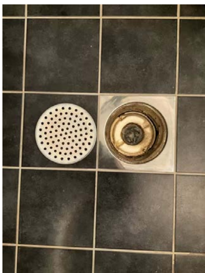
Viser sluk i dusjsone.
