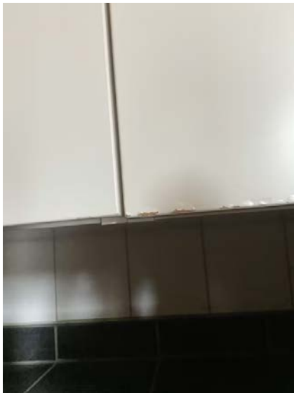
Viser små fuktskader på baderomsinnredning.
