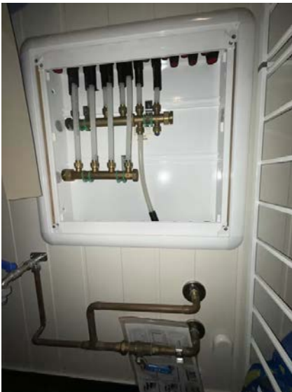
Viser hovedstoppekran. Innvendig installasjoner i fordelerskap.
