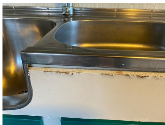
Slitasje på innredningen.
