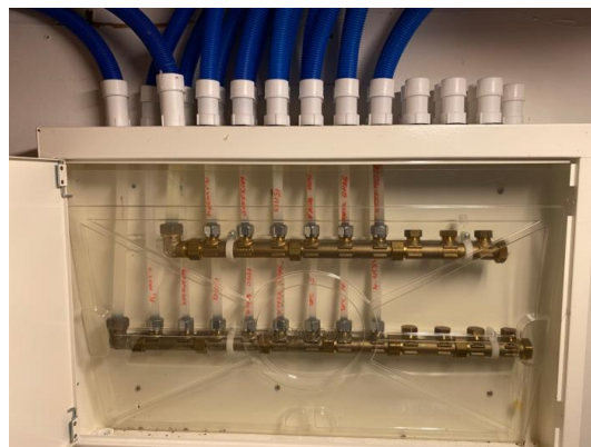
Rør i rør skap.
