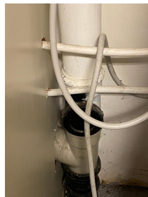
Avløpsrør ved vaskemaskin.
