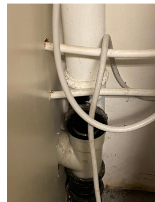
Avløpsrør ved vaskemaskin.
