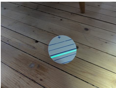
Måling av skjevhet/retningsavvik på gulv i stue 2. etg
