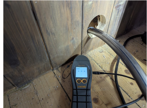
Fuktsøk i vegg bak dusjsone. Det er målt mindre enn 8 vekt-% fukt (tørt).
