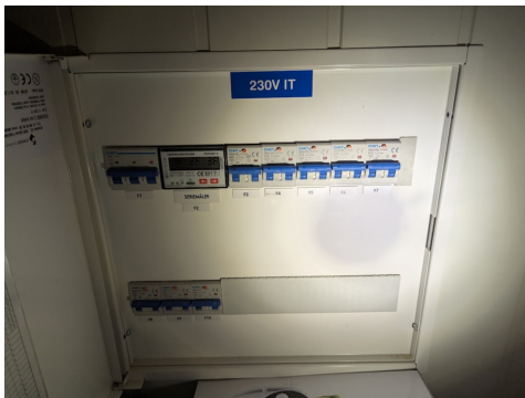
Innmat i sikringskapp - loftplan
