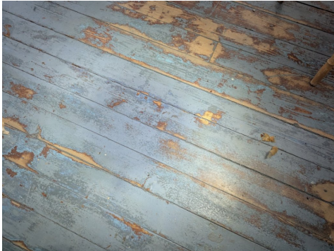
Overflateavvik i gulv
