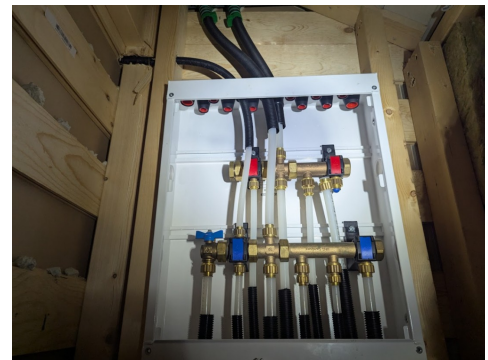
Fordelerskap for rør-i-rør
