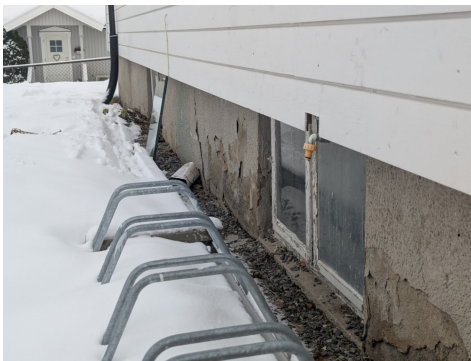
Avskallinger i grunnmur
