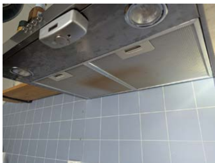
Kjøkkenventilator 2 ETG. > KJØKKEN
