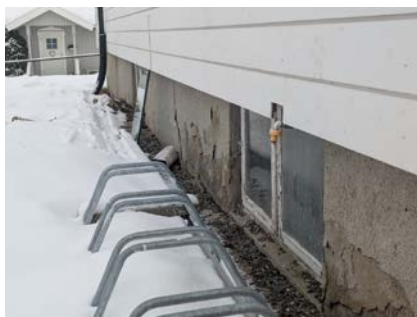
Avskallinger i grunnmur
