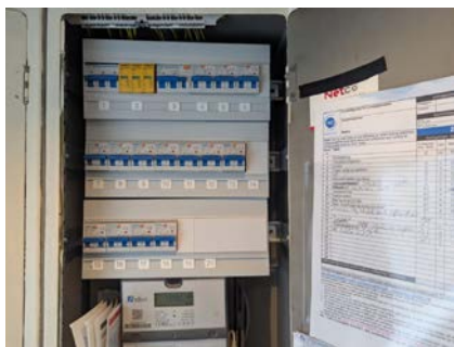
Inmat i sikringsskap - hovedskap
