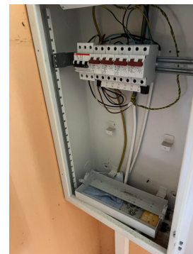
Sikringskap annekset/gammelt hus
