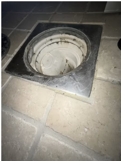
Viser sluk under dusjkabinett. Det registreres mindre hakk i slukpotte under klemring.
