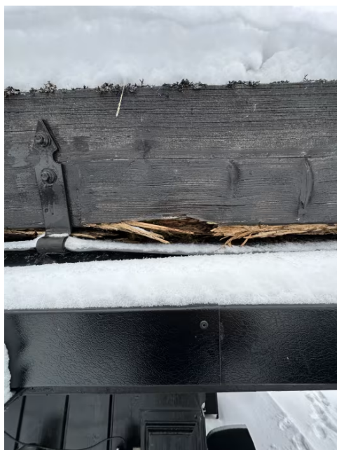
Viser råteskader i torvstokk.
