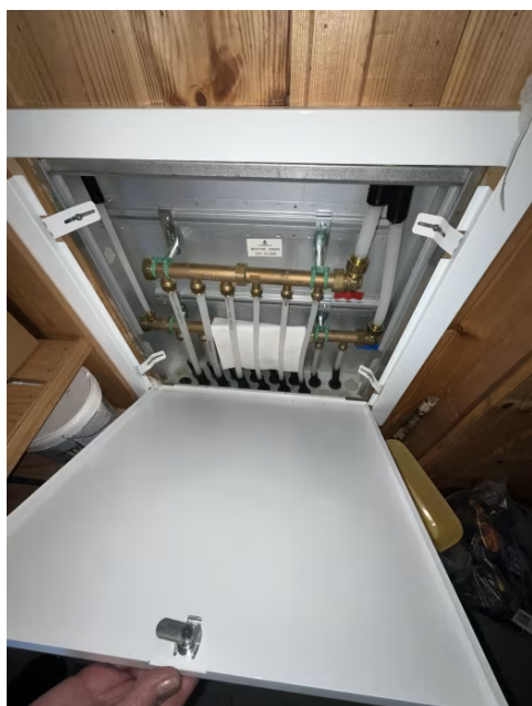
Vannrør med rør i rør system fra fordelerskap plassert i bod og frem til sanitærinstallasjoner på badetrom, toalettrom og kjøkken.
