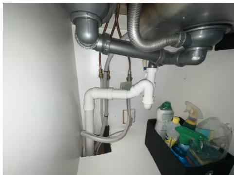
Viser vann og avløpsinnstallasjoner under kum.
