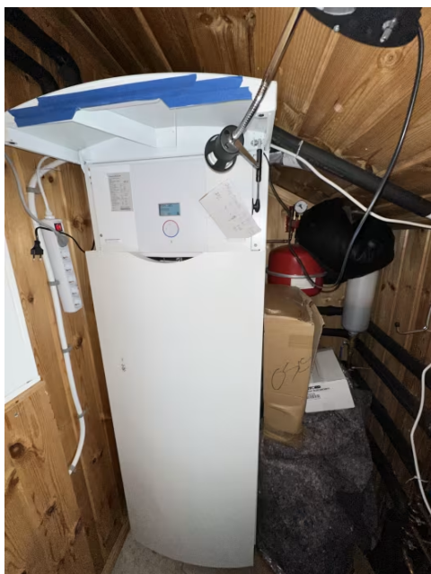
Thermia Diplomat bergvarmepumpe for gulvvarme og forbruksvann.
