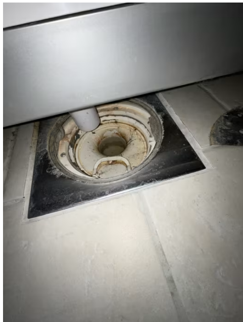
Viser sluk under dusjkabinett.
