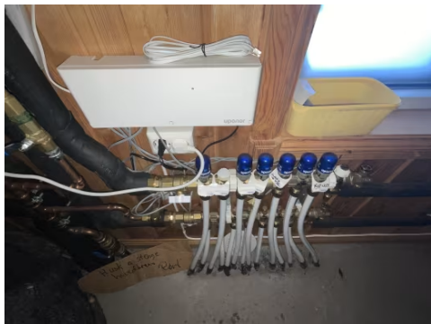
Viser vannbåren gulvvarme plassert i bod med utvendig adkomst.
