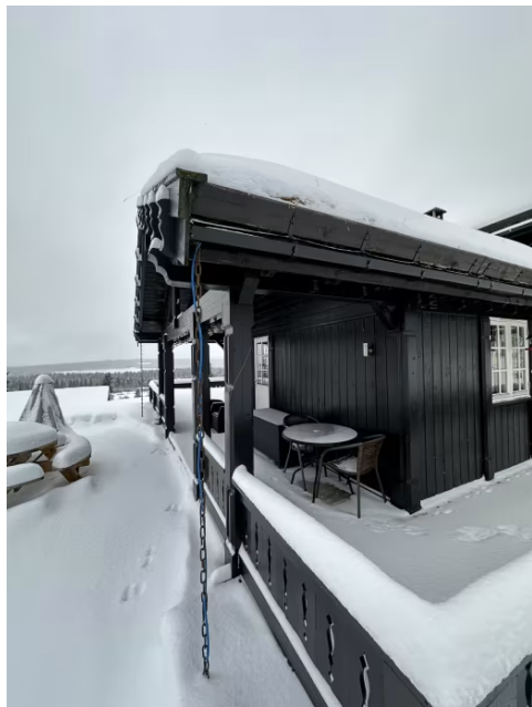
Viser takrenne, nedløp med kjetting og varmekabel.
