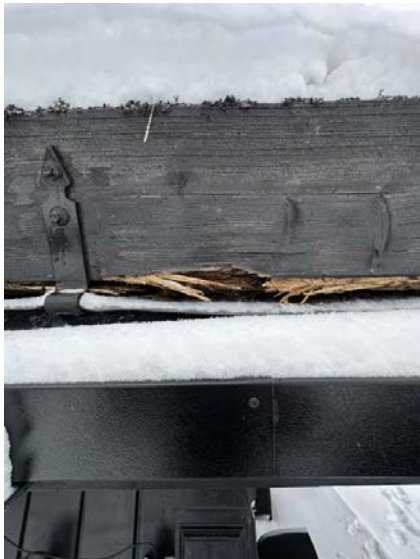
Viser råteskader i torvstokk.
