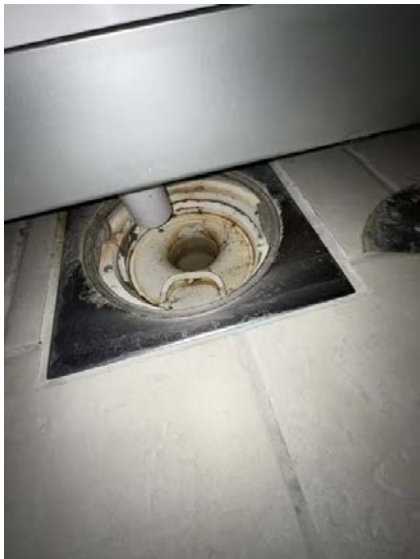
Viser sluk under dusjkabinett.
