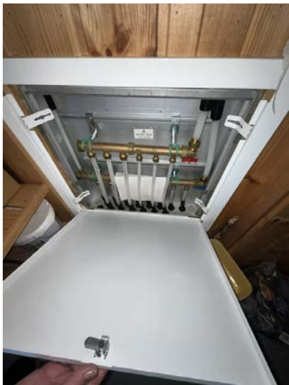
Vannrør med rør i rør system fra fordelerskap plassert i bod og frem til sanitærinstallasjoner på badetrom, toalettrom og kjøkken
