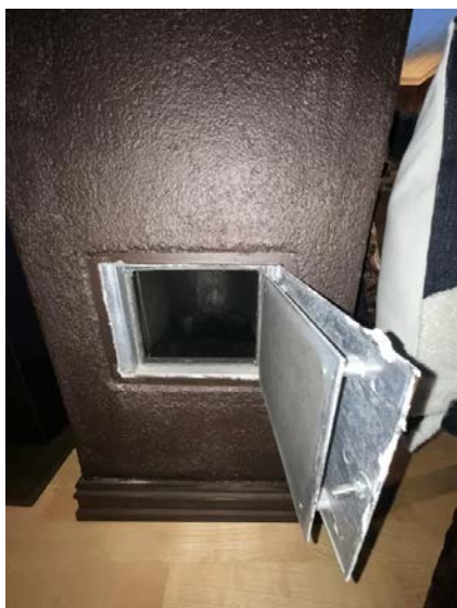
Viser sotluke plassert i stue. Ubrennbar plate under sotluke må monteres.
