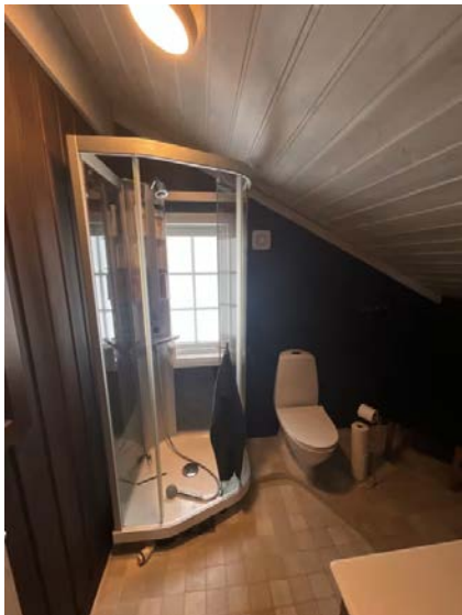
Viser dusjkabinett og gulvstående toalett.
