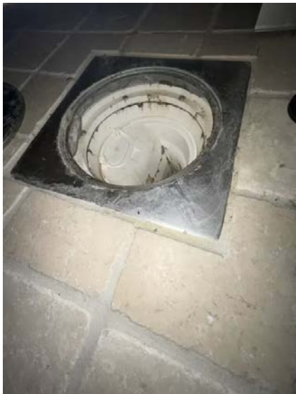
Viser sluk under dusjkabinett. Det registreres mindre hakk i slukpotte under klemring.
