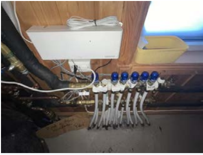
Viser vannbåren gulvvarme plassert i bod med utvendig adkomst.
