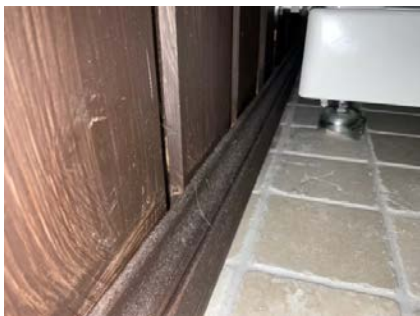
Det er benyttet uegnede materialer i våtsonen som ikke vil tåle belastningen av fritt vann.
