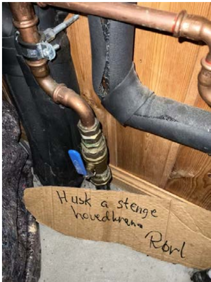
Viser vanninntak og hovedstoppekran.
