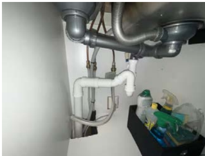
Viser vann og avløpsinnstallasjoner under kum.
