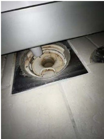
Viser sluk under dusjkabinett.
