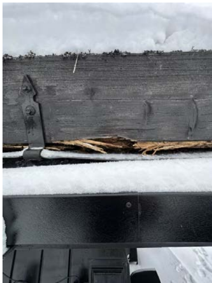
Viser råteskader i torvstokk.
