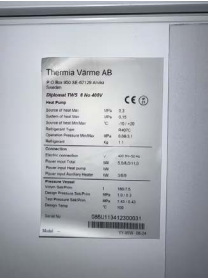
Viser teknisk data på pumpe.
