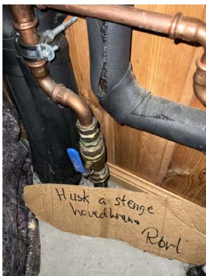
Viser vanninntak og hovedstoppekran.
