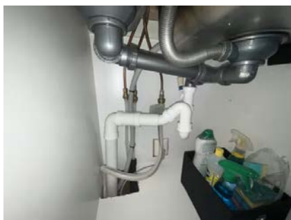
Viser vann og avløpsinnstallasjoner under kum.
