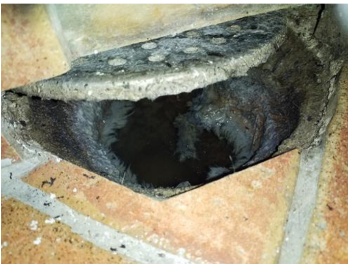
Helhetsvurdering - [Sluk i vaskerom.]
