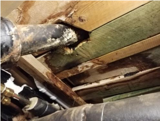
Kommentar - [Fuktskjolder i himling bod 2.]
