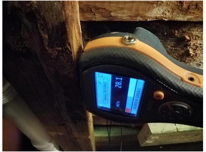
Kommentar - [Fuktmåling i treverk i himling bod 2]
