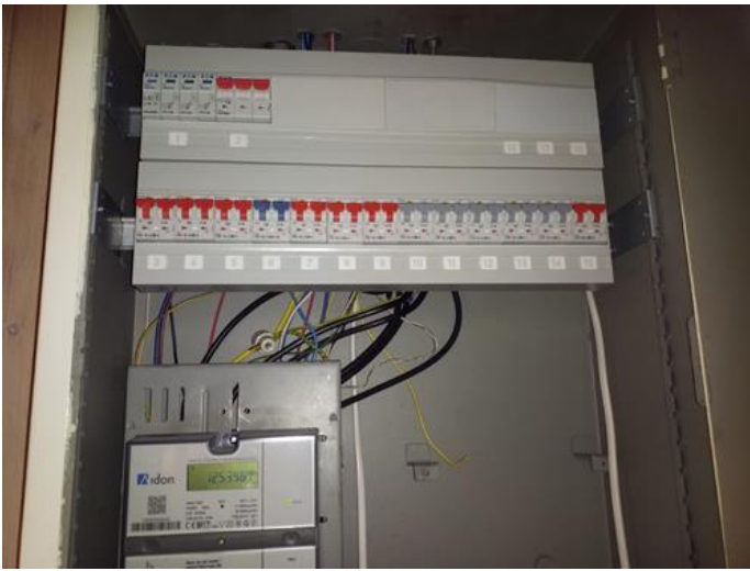
Forenklet vurdering av det elektriske anlegget - [Sikringskap. ]
