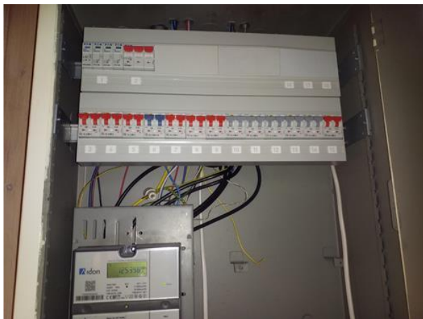
Forenklet vurdering av det elektriske anlegget - [Sikringskap.]
