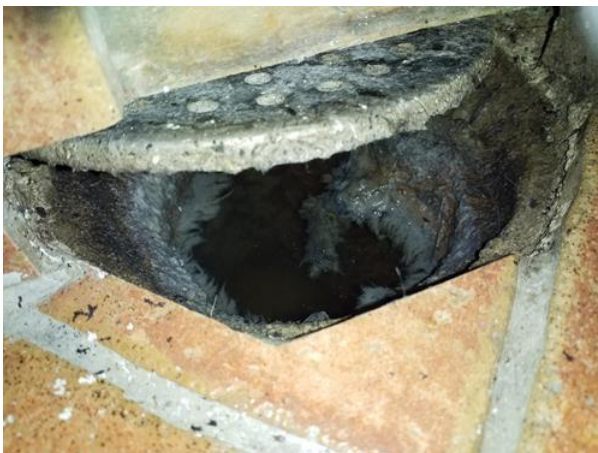
Helhetsvurdering - [Sluk i vaskerom.]
