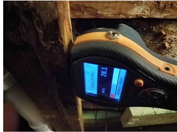
Kommentar - [Fuktmåling i treverk i himling bod 2]
