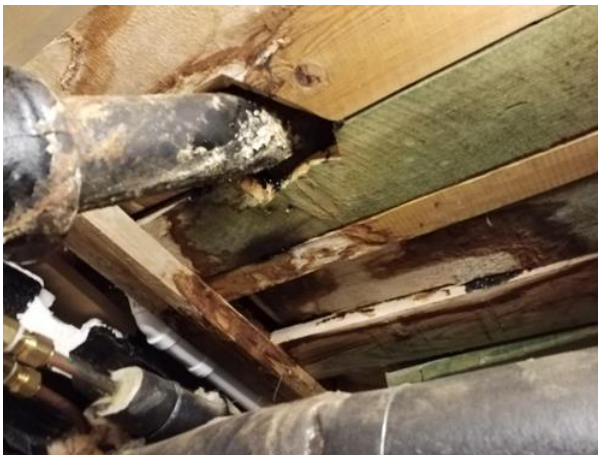
Kommentar - [Fuktskjolder i himling bod 2.]
