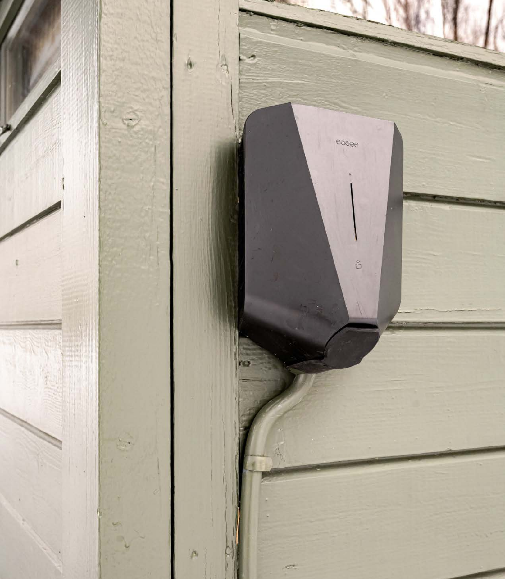
Det er montert elbil-lader på hytteveggen.
