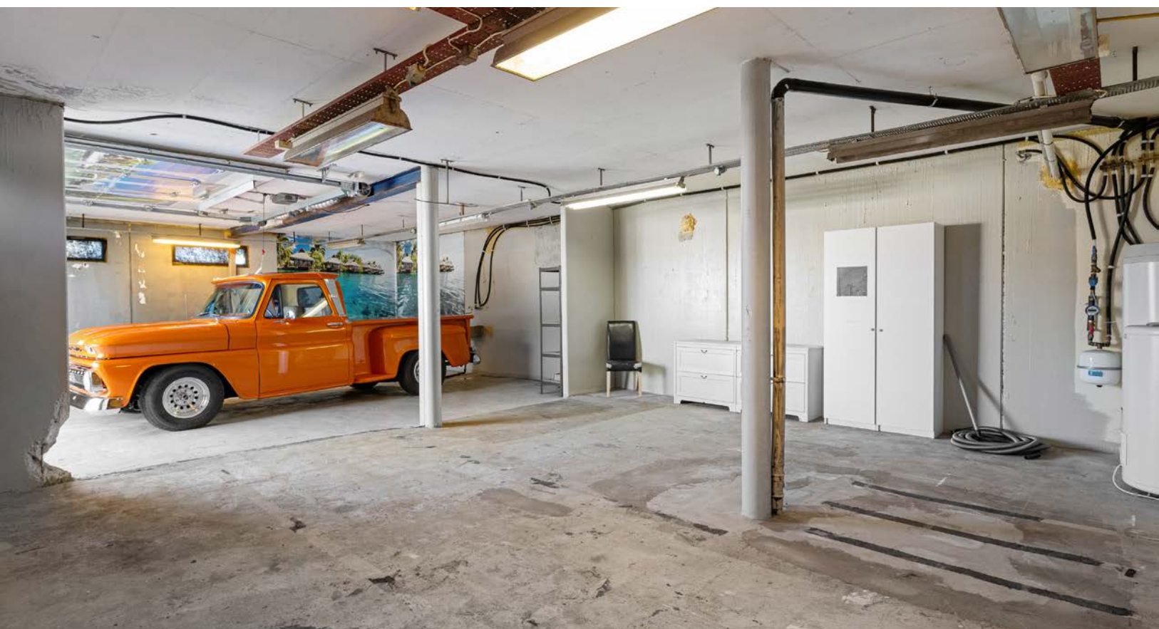
Verkstedet har direkte tilgang til boligen gjennom brannndør. (fjerning av vegg mellom garasje hvor bil står og rom beskrevet som «hobbyrom» på godkjente tegninger er ikke godkjent)
