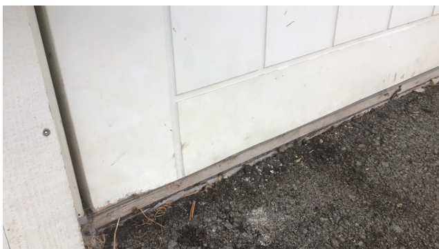
Fukt svelling i nedkant boddør
