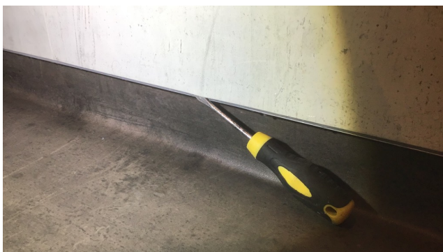
Fukt skader i nedkant plater
