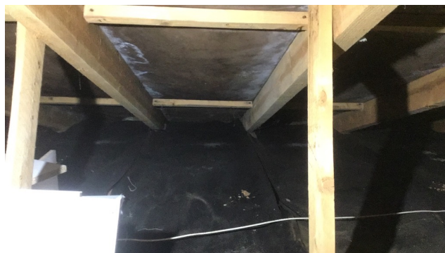
Mangelfull luftespalte i nedkant tak
