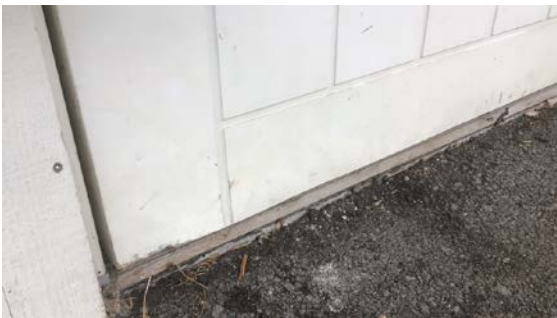
Fukt svelling i nedkant boddør
