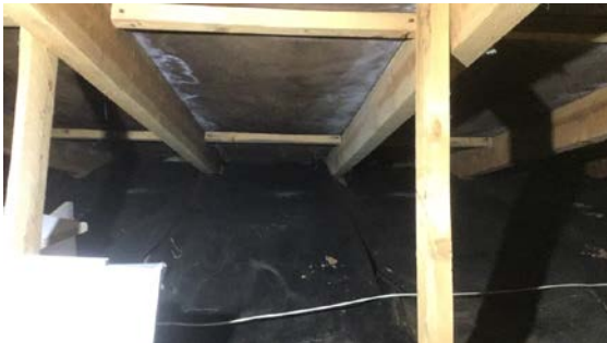
Mangelfull luftespalte i nedkant tak
