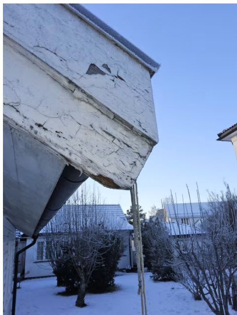
Bilde viser råteskade på fasade.
