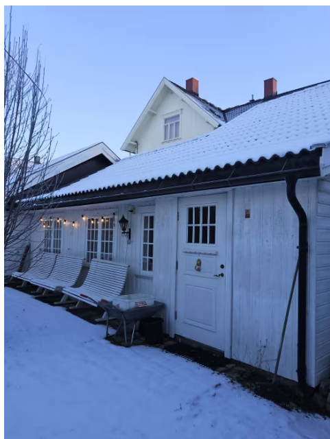
Bilde viser snødekt tak.
