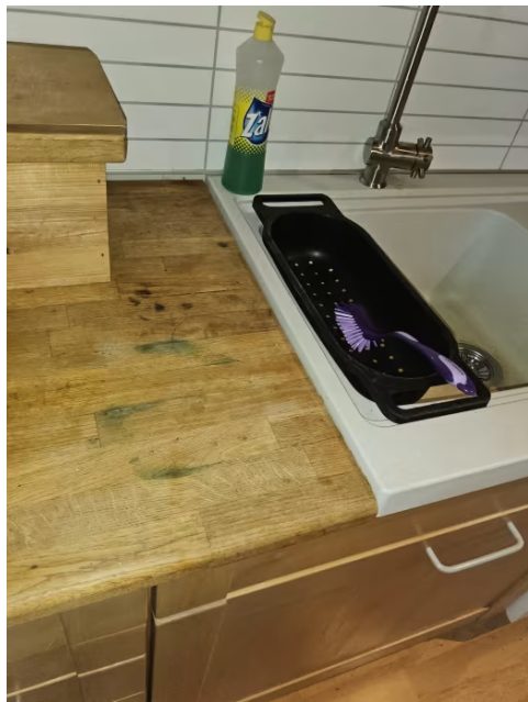
Bilde viser slitt benkeplate ved oppvaskkum.
