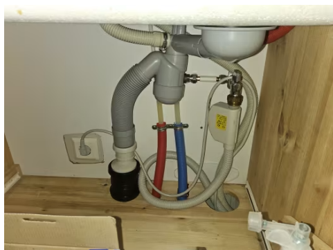
Bilde viser røropplegg under oppvaskkum.
