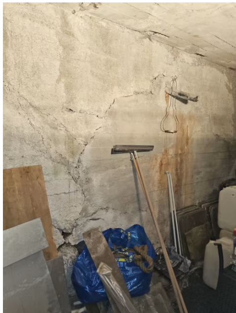
Bilde viser sprekk i mur i jordkjeller.
