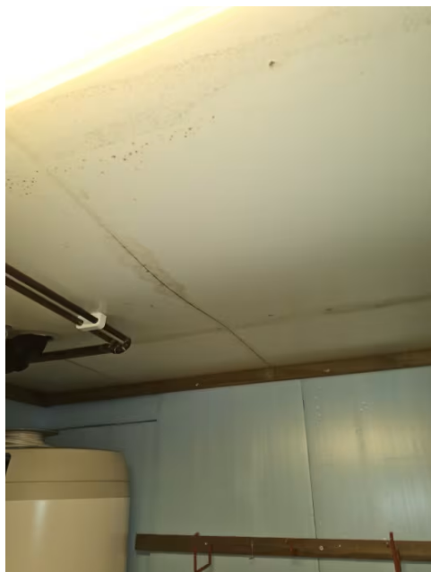
Bilde viser fuktmerker i himling under bad.
