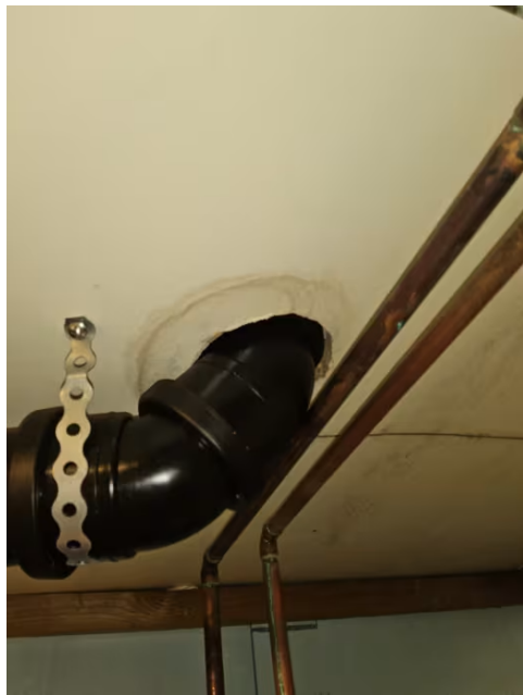
Bilde viser fuktmerker i himling under bad.
