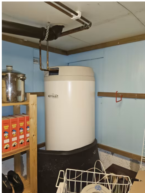
Bilde viser varmtvannsbereder.
