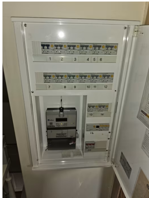
Bilde viser sikringsskap.
