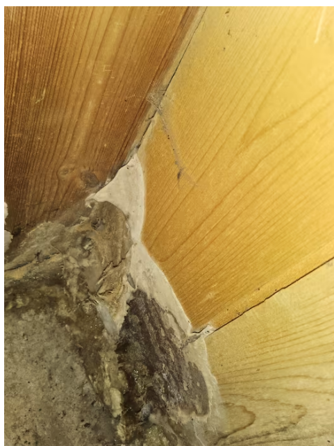
Bilde viser soppdannelse i underetasjen.
