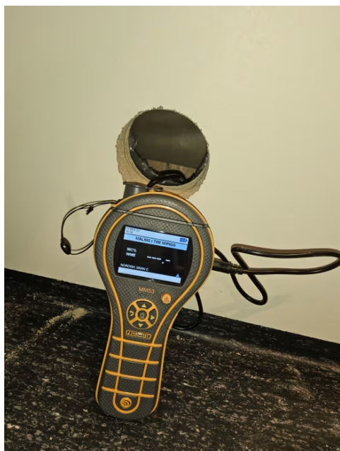
Bilde viser fuktmåling på vaskerom. Bilde viser plast i konstruksjonen.
