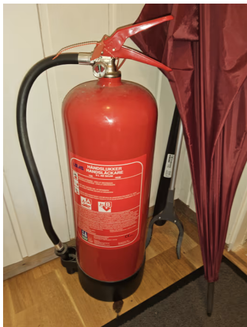
Bilde viser brannslukningsapparat.
