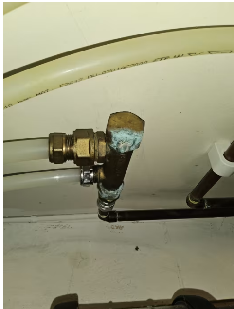
Bilde viser drypplekkasje.
