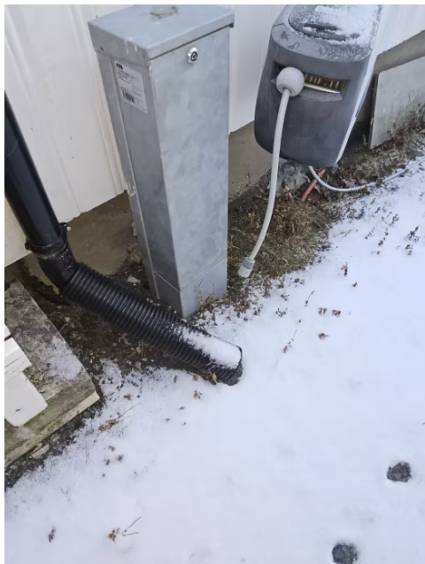
Bilde viser mangelfull bortledning av takvann.
