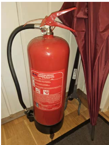
Bilde viser brannslukningsapparat.
