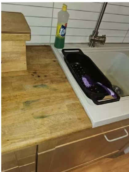
Bilde viser slitt benkeplate ved oppvaskkum.
