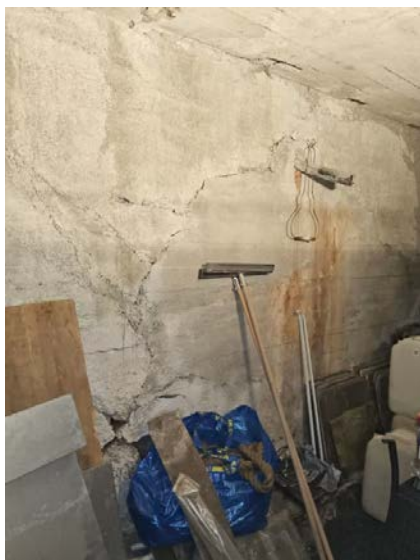
Bilde viser sprekk i mur i jordkjeller.
