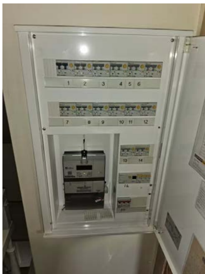
Bilde viser sikringsskap.
