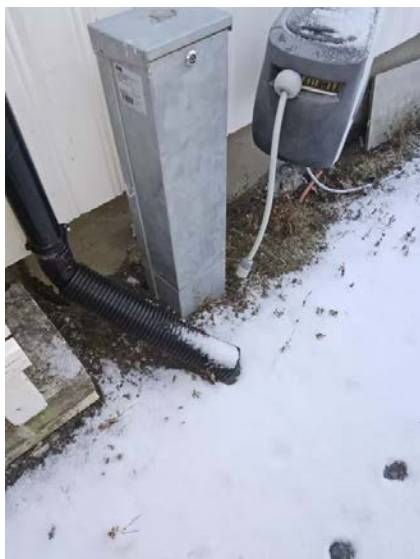
Bilde viser mangelfull bortledning av takvann.
