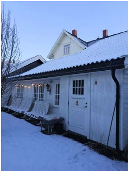
Bilde viser snødekt tak.
