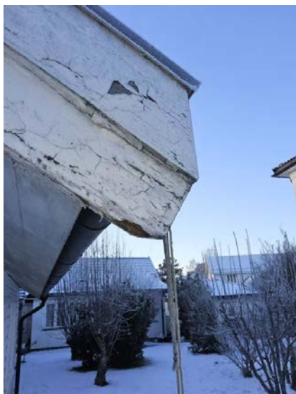
Bilde viser råteskade på fasade.
