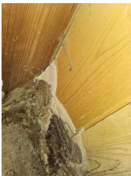
Bilde viser soppdannelse i underetasjen.
