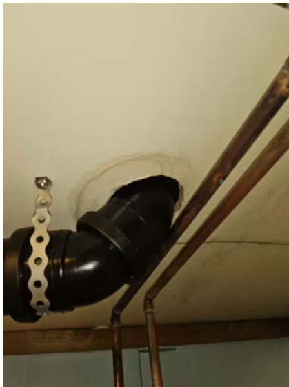
Bilde viser fuktmerker i himling under bad.
