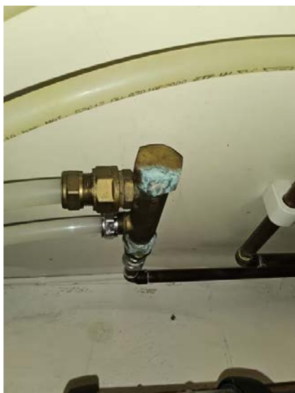
Bilde viser drypplekkasje.
