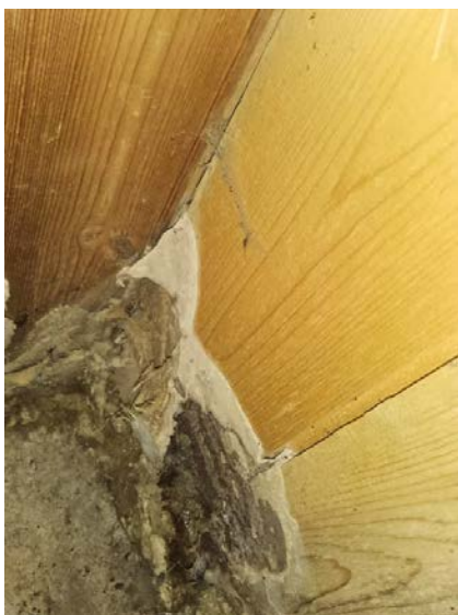
Bilde viser soppdannelse i underetasjen.
