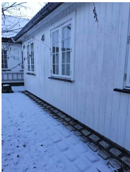
Bilde viser slitt kledning ført for nærmer terreng.
