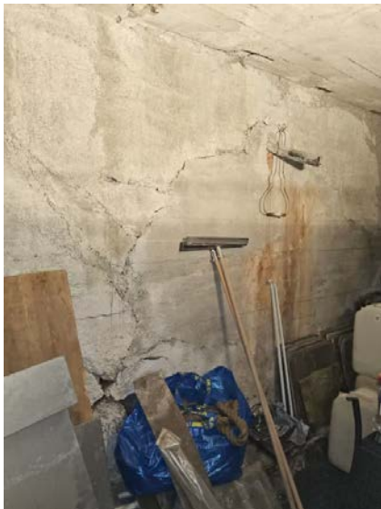
Bilde viser sprekk i mur i jordkjeller.
