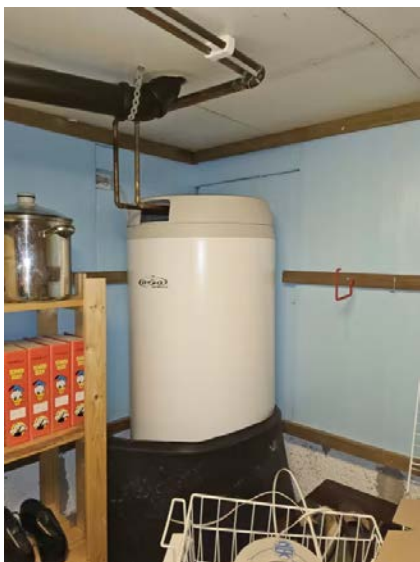
Bilde viser varmtvannsbereder.
