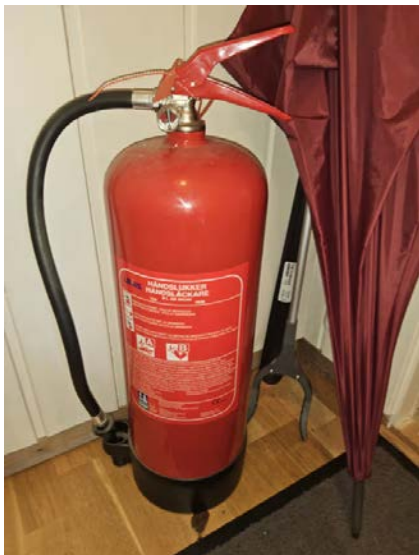
Bilde viser brannslukningsapparat.
