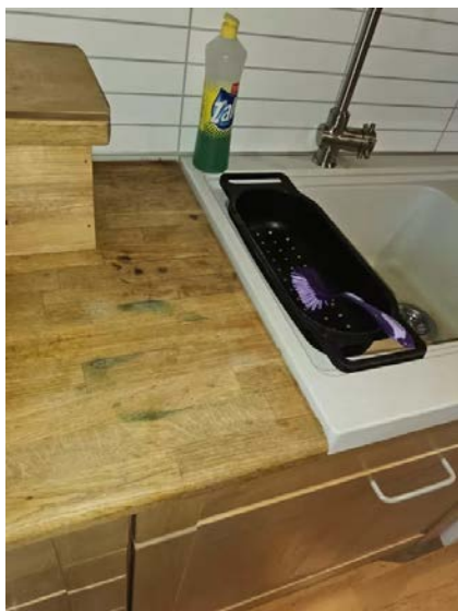
Bilde viser slitt benkeplate ved oppvaskkum.
