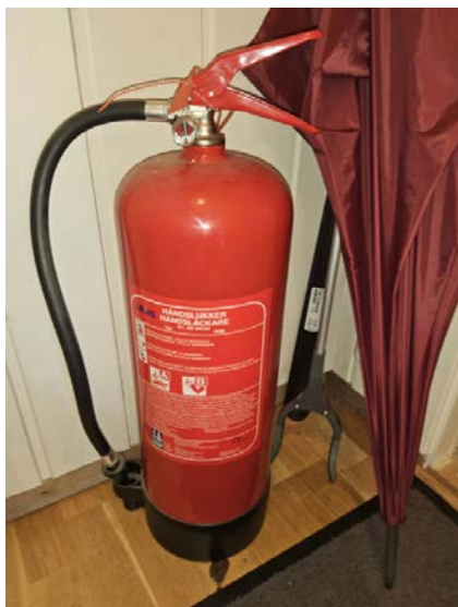
Bilde viser brannslukningsapparat.
