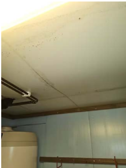
Bilde viser fuktmerker i himling under bad.
