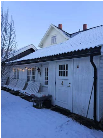
Bilde viser snødekt tak.
