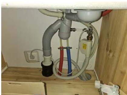
Bilde viser røropplegg under oppvaskkum.
