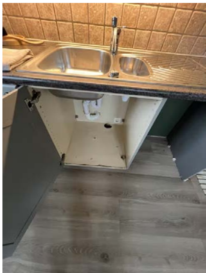
Fuktskade registrert i underskap kjøkken 1.etasje.
