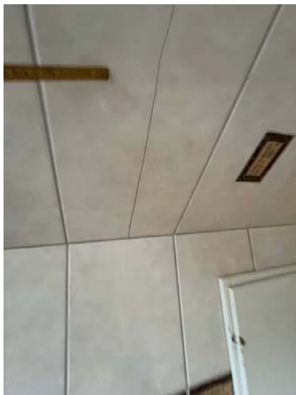
Sprekker i flislagt skrå himling over toalett, det ble også påvist skader i flislagt gulv på bad og i dusj.
