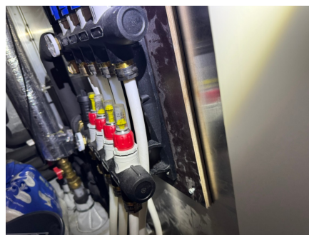
Samlestocken er løs fra veggfestet.
