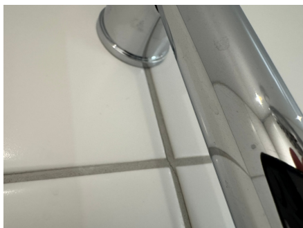
Riss i fuge i dusnisjen.
