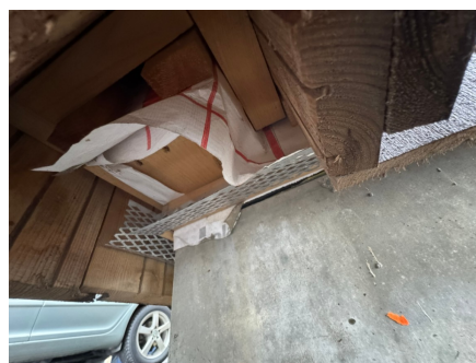
Ufagmessig utførelse av vindsperre.
