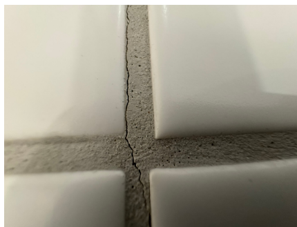
Riss i fuge i dusnisjen.
