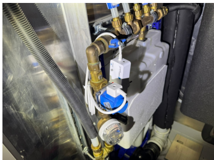
Vannstoppeventilen er ikke tilkoblet.
