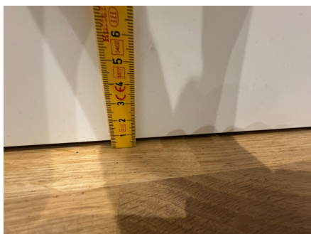
luftespalte under dør.
