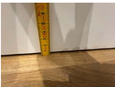
luftespalte under dør.
