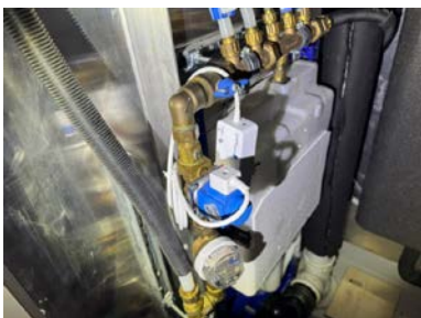
Vannstoppeventilen er ikke tilkoblet.
