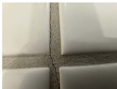
Riss i fuge i dusnisjen.
