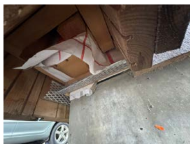
Ufagmessig utførelse av vindsperre.
