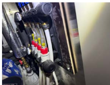
Samlestocken er løs fra veggfestet.
