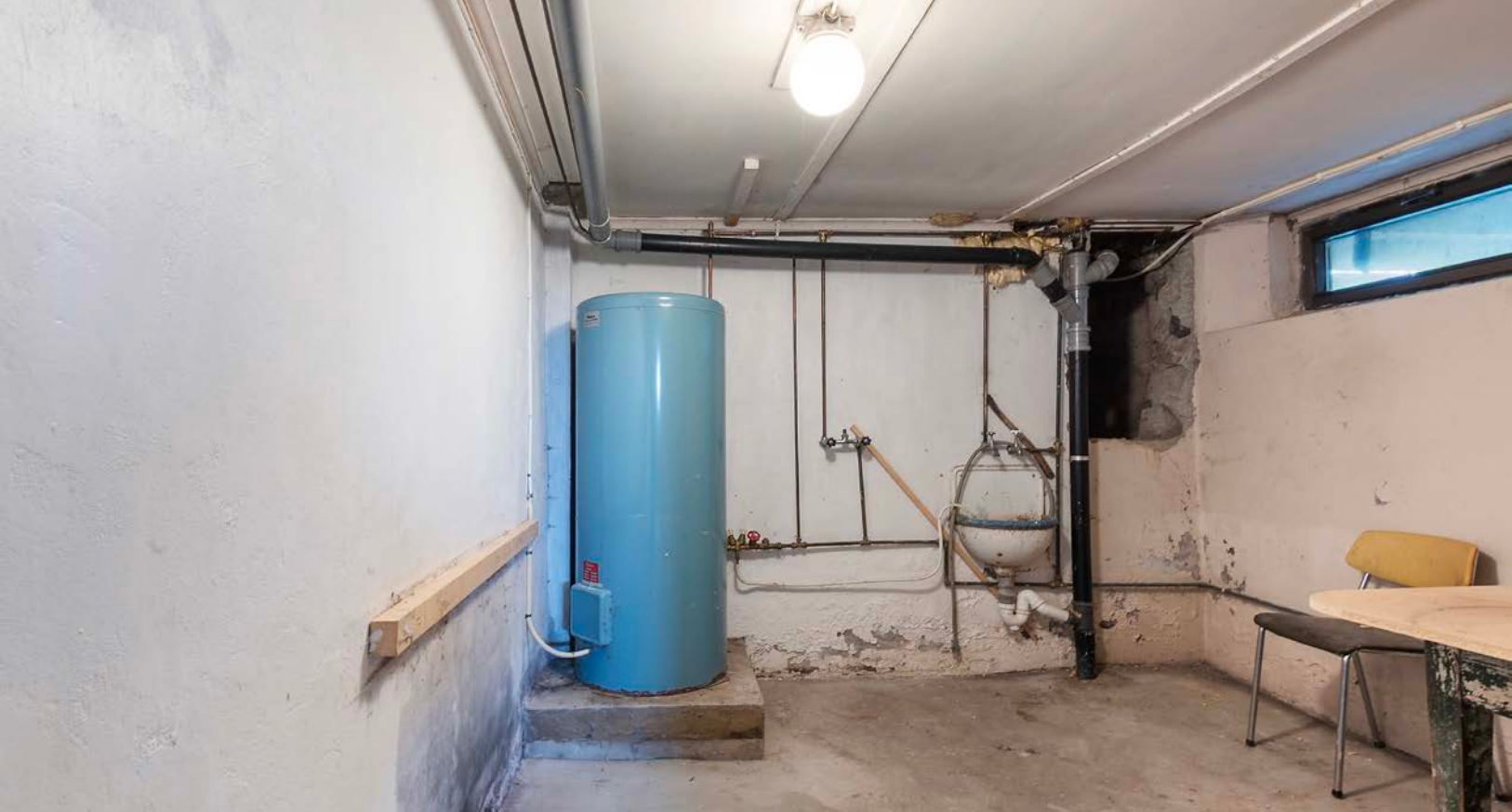
Teknisk rom i kjeller.
