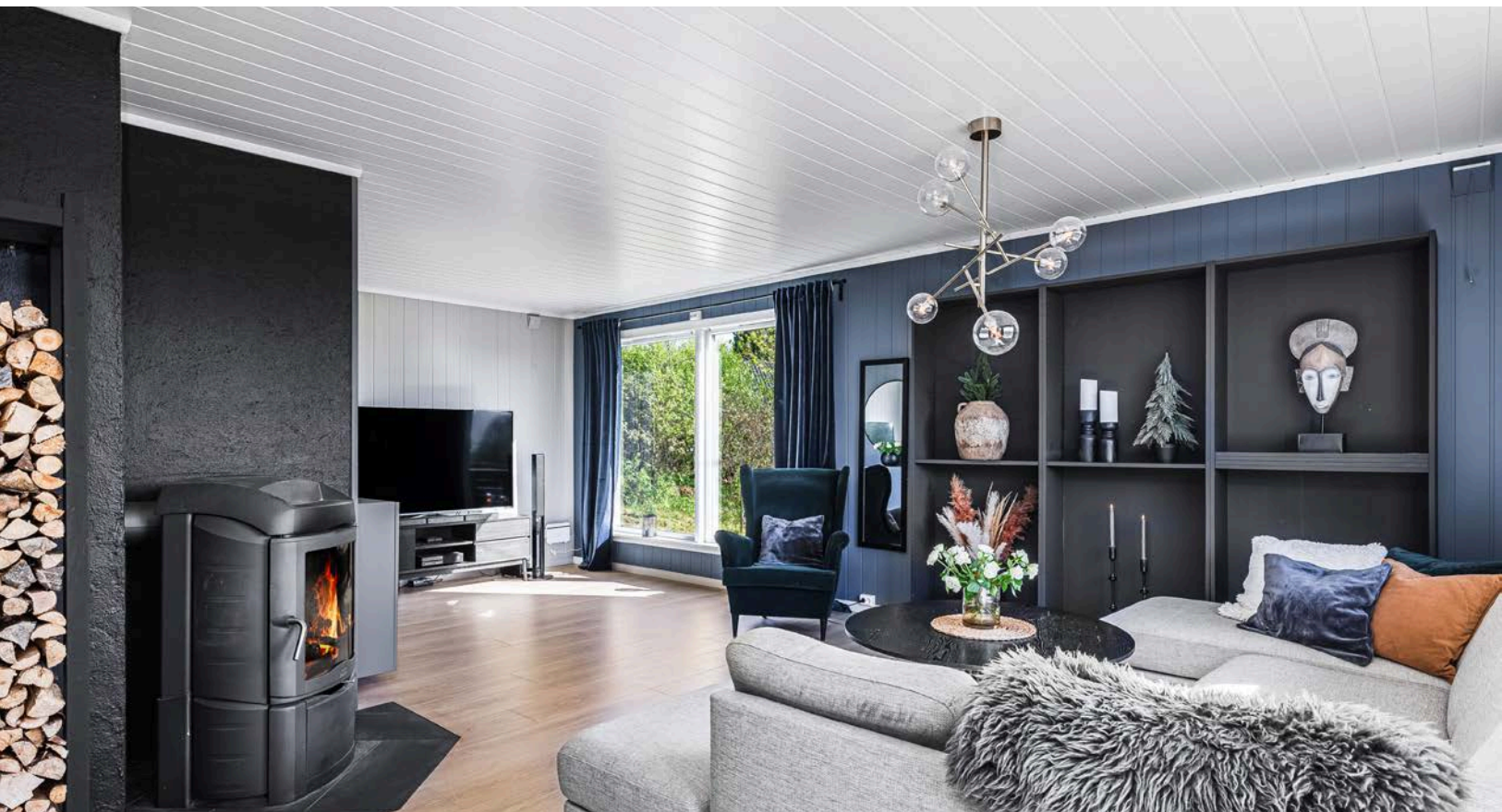
Oppvarming med luft-luft varmepumpe (trappeløp) installert i 2016 og vedovn fra 2009. I tillegg er det en Jøtul 602 vedovn i sokkeletasjen.
