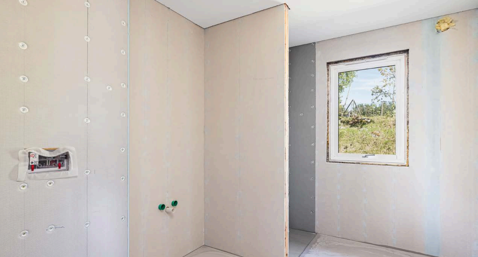
Bad er påbegynt rehabilitert. Membran og flisarbeid er ikke påbegynt. Vindu i våtsone av ikke egnet materiale.
