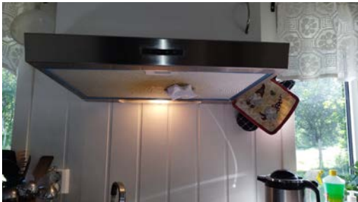
Test av avtrekket.
