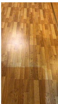
Bildet viser sprekk i laminatgulv på stuen.
