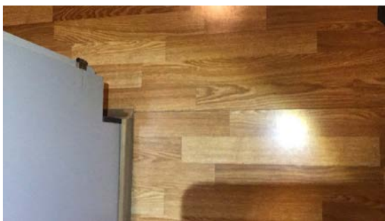
Bildet viser sprekk i laminatgulv på soverom.
