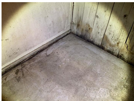
Fukt- og råteskader på delevegger av tre.
