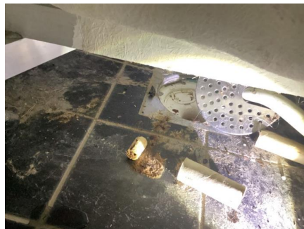
Sluk ikke tilgjengelig for nærmere inspeksjon.
