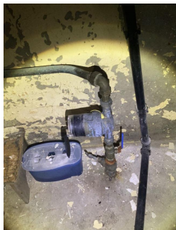
Vanninntak med måler og stoppekran i kjeller.
