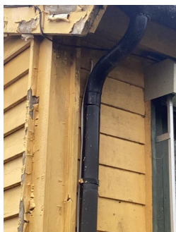
Løs innfesting og frostspreng på taknedløp.
