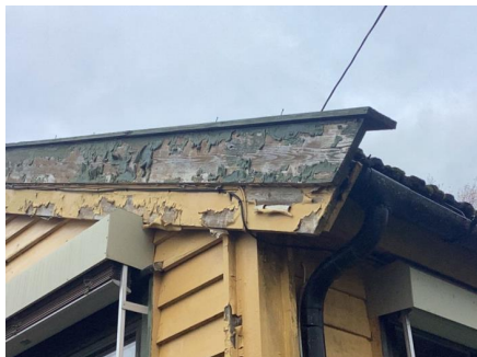
Eksempel på utvendig tilstand.
