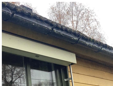
Mosevekst og misfarging på overflater.
