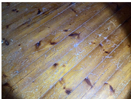
Eksempel på slitasje på gulv.
