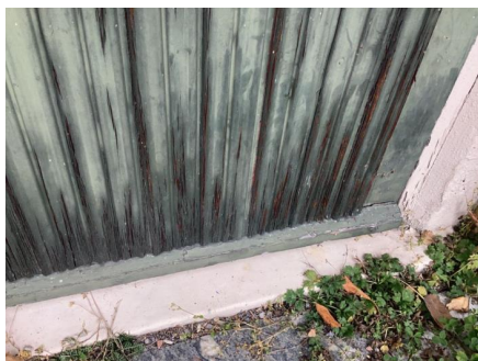
Slitasje på kjellerdør.
