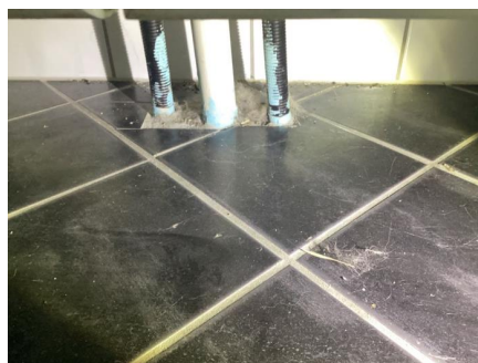
Stedvis tegn til bruk av smøremembran ved gjennomføringer.
