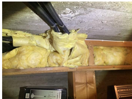
Store deler av vannrør er skjult av isolasjon.
