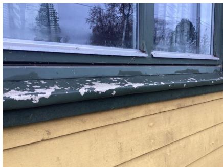
Eksempel på avskaling på beslag.
