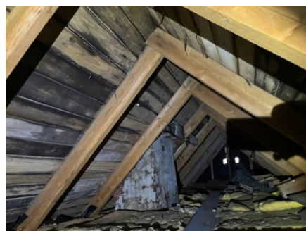
Eksempel på misfarging på loft over 2. etasje.
