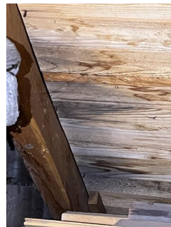
Fuktmerker på loft over 1. etasje.
