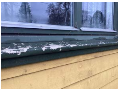
Eksempel på avskaling på beslag.
