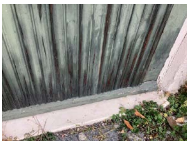
Slitasje på kjellerdør.
