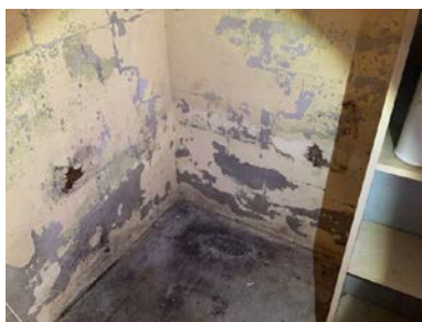
Eksempel på avskaling på vegger.
