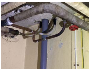
Rør i rør system er avsluttet i rom uten sluk.
