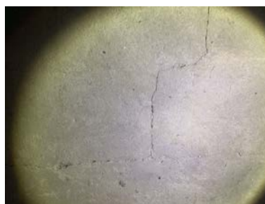
Eksempel på innvendige sprekker.
