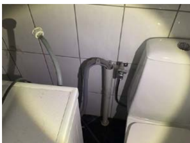
Det drypper fra vannkran, står vannspeil på gulv på befaring.
