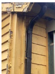
Løs innfesting og frostspreng på taknedløp.
