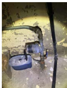
Vanninntak med måler og stoppekran i kjeller.
