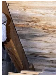
Fuktmerker på loft over 1. etasje.
