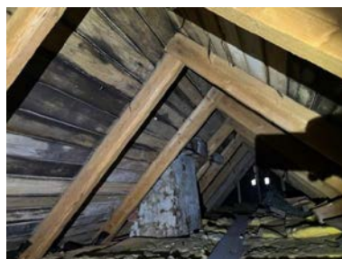
Eksempel på misfarging på loft over 2. etasje.
