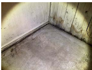
Fukt- og råteskader på delevegger av tre.
