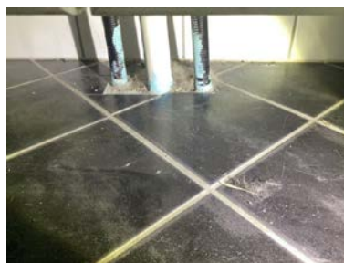
Stedvis tegn til bruk av smøremembran ved gjennomføringer.
