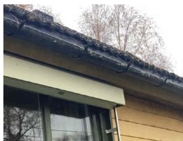
Mosevekst og misfarging på overflater.
