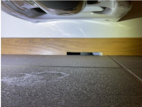
Drenering fra innbyggings-sisterne
