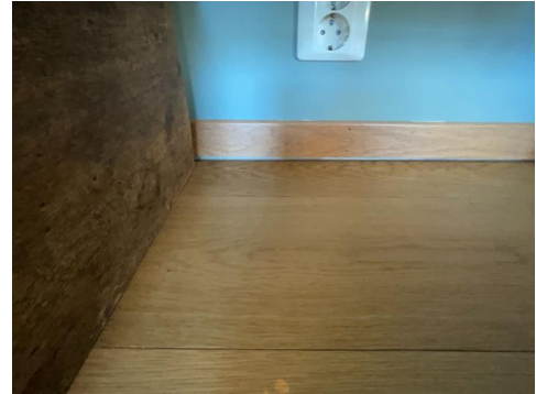
Glipping mellom fotlist og parkett ved tunge møbler
