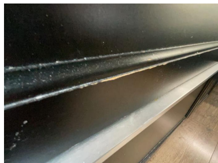
Fronter er dels noe malingslitt.
