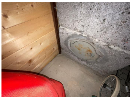
Sotluke nærme brennbart materiale.
