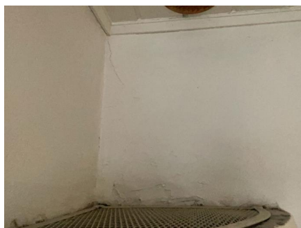
Sprekk i pipe/puss.
