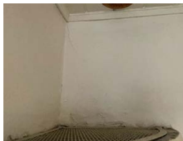
Sprekk i pipe/puss.
