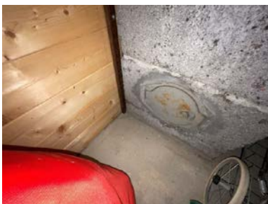
Sotluke nærme brennbart materiale.
