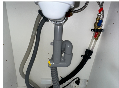
Røropplegg i kjøkkenbenk med Waterguard
